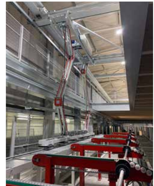
Saugtraverse einer doppelstöckigen Anlage
